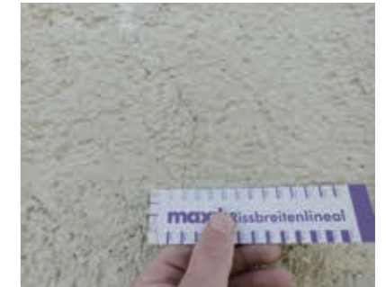
Messung der Rissbreiten. Ruhende Risse mit Rissbreiten bis 0,2 mm überarbeitbar.
