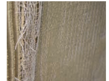
Auftrag von maxit ip 339 mit Einlage aus maxit Armierungsgewebe Lehm. Auftragsdicke 5 – 8 mm.
