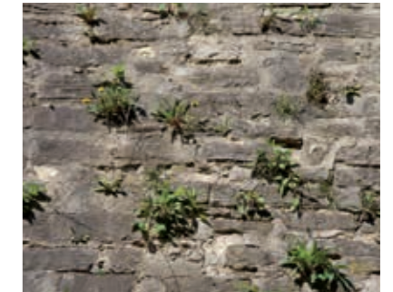
Bestandsmauerwerk mit stark geschädigten Fugen. Fehlende Flankenhaftung des Fugenmörtels führt zu Bewuchs und Schädigung.
