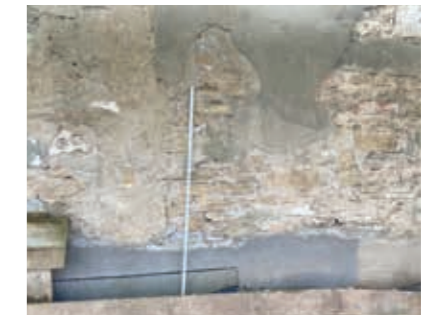
Typische Schadensbilder im Sockelbereich bei Feuchte- und Salzbelastung.
