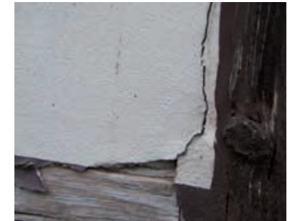
Typisches Schadensbild bei Fachwerkgefachen: Überputztes Holz, kein Kellenschnitt, Holzanstrich mit nicht geeigneter Farbe.
