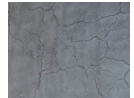
Sichtbare Schwindungsrisse nach Reinigung des Untergrundes.
