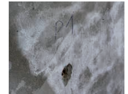
Probenahmen geben Auskunft über den Salzgehalt im Untergrund und im Putz. Abhängig von den Ergebnissen ist der Auftrag eines Kompressenputzes zu wiederholen.
