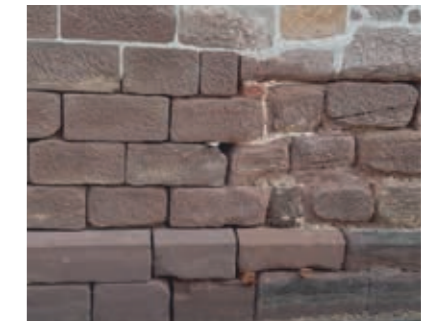
Bestandsmauerwerk. Stark geschädigter, versalzener, poröser Fugenmörtel.
