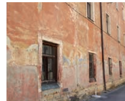
Typische Schadensbilder wie Feuchteflecken, Anstrich- und Putzabplatzungen lassen auf eine hohe Feuchte- und Salzbelastung schließen.
