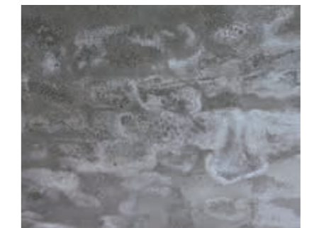
Feuchtflecken und Salzausblühungen zeigen den Transport der vorliegenden Salze an die Oberfläche des Putzsystems.
