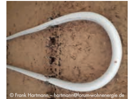
Ausgleichsschicht mit maxit ip 338/ maxit ip 339, Befestigung von Heizungs- rohren an Schienen.
