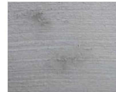
Porengrundputz. Bei hohen Konzentrationen bauschädlicher Salze ist Salzdurchschlag möglich.
