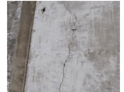
Bauwerksbedingte Risse: gerichteter Verlauf, Risstiefe bis zum Putzgrund, Rissbreiten > 0,5 mm.
