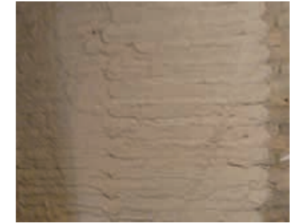
Auftrag einer Putzschicht mit maxit ip 380 purcalc oder maxit ip 380 L purcalc in einer Auftragsdicke von 15 – 20 mm.
