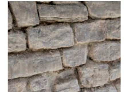
Freigelegte gereinigte Fugenbereiche. Tiefe Fugen bis zu 80 mm.
