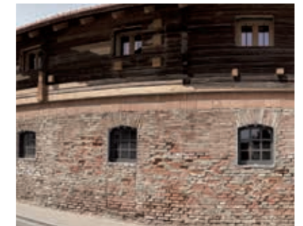
Stark geschädigtes, freigelegtes Mauerwerk.
