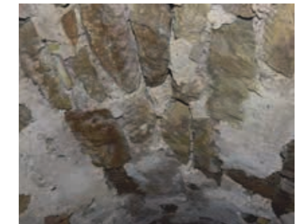
Bestandsmauerwerk. Stark geschädigter, versalzener, poröser Fugenmörtel.
