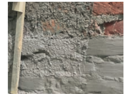
Auftrag der Bauwerksabdichtung im erdberührten Bereich, Reduzierung des Wassereintrages in die Konstruktion.
