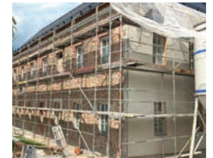
Altbau Ziegelmauerwerk mit feuchte- und salzbelastetem Untergrund im Sockel.
