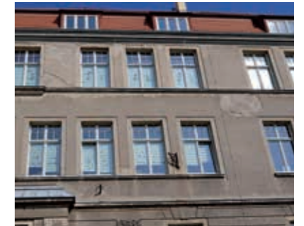
Altbestand: Putzablösungen, Risse und gestörte Festigkeiten.
