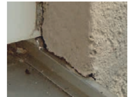
Anschlüsse, Fugendichtbänder sind bei einer Überarbeitung der Fassade instandzusetzen.
