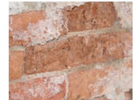
Hohe Salzbelastung und sichtbare Zerstörung des Ziegels an der Oberfläche. Nitratbelastung > 1 M.-%.
