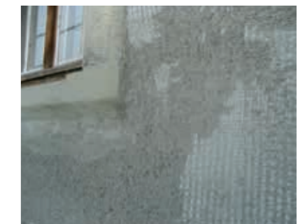
Unterputz mit maxit san Grund oder maxit ip 380 purcalc mit einer Auftragsdicke von 20 mm. Oberfläche aufräumen.
