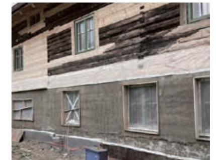
Sanierputzsystem mit nicht flächendeckendem maxit san Vorspritz und Unterputz mit maxit san Standard.
