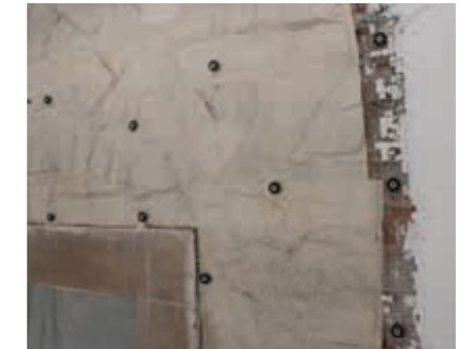
Im Rissbereich Entfernung des Putzes bis zum Putzgrund. Entkopplung des Risses durch Aufbringen einer Trennlage ca. 20 cm um den Riss.
