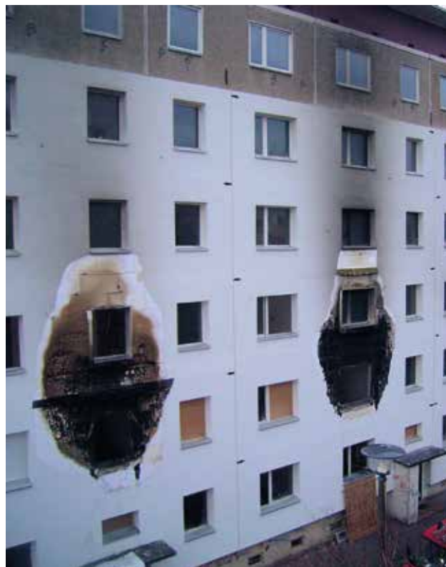
Bild 16: Versuchsgebäude mit EPS-WDVS nach den Brandversuchen, Putz teilweise entfernt – Brandriegel verhindern geschossübergreifende Brandweiterleitung
