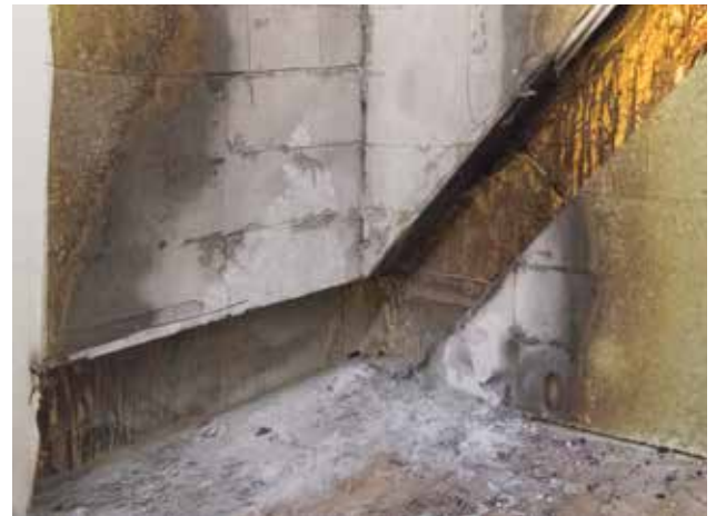
Bild 30: Brandschädigung im Spritzwasserbereich (nach Entfernung des Putzsystems)
