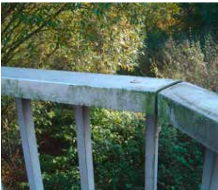
Bild 3: Algenbewuchs auf einem Geländer
