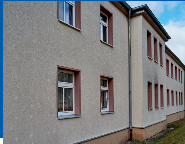
Entlang der gesamten Hausfassade zu sehen: Die Dübel des unter der Putzschicht liegenden WDV-Systems zeichneten sich bei den Häusern einer Wohnanlage in Raschau deutlich ab.
