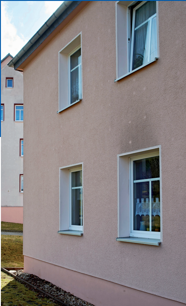
Fehlender Fassadenschutz: Dübelabzeichnungen fielen als helle Flecken insbesondere in den Bereichen mit starker Veralgung unangenehm auf. Dies ist nicht nur eine optische Misere, sondern schadet auf Dauer auch der Außenwand.
