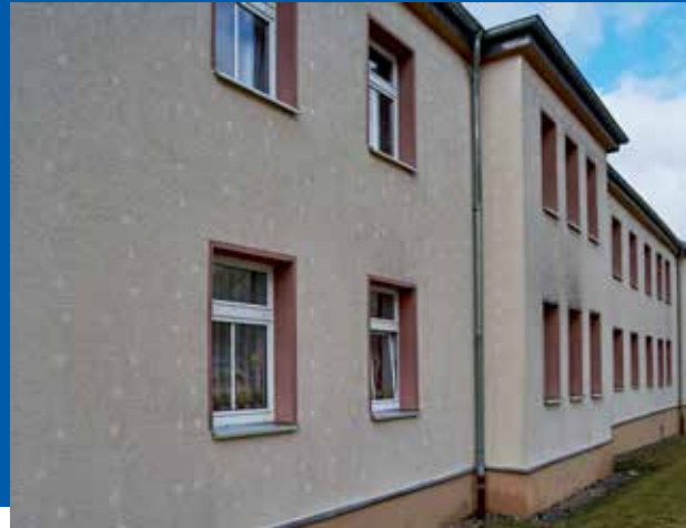
Entlang der gesamten Hausfassade zu sehen: Die Dübel des unter der Putzschrift liegenden WDV-Systems zeichnen sich bei den Häusern einer Wohnanlage in Raschau deutlich ab.
