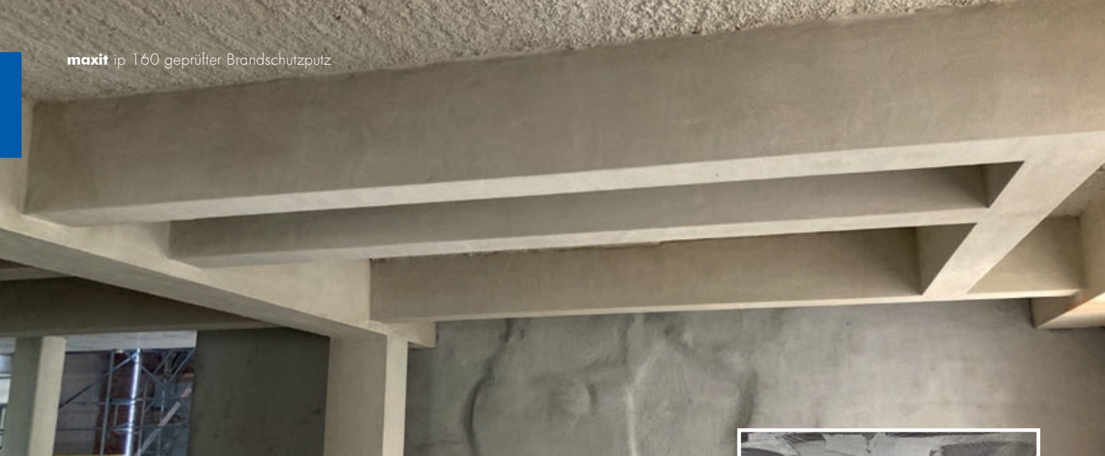
Gefilzte Stahlbetonstützen und -unterzüge treffen auf spritzraue Decken.
