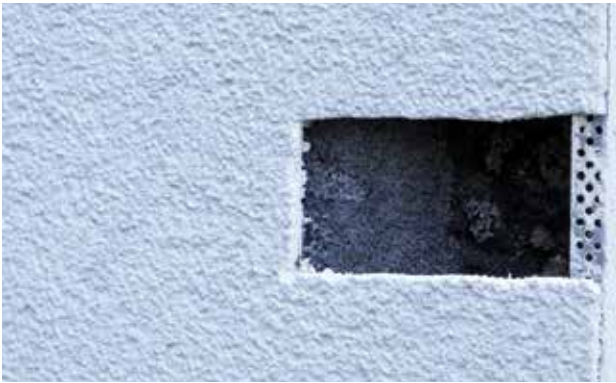
Die Inspektionsöffnung beweist: Zwar hat die maxit Polystyrolämmung durch den Schaden der Nachbarfassade im direkten Stoß Schmauchspuren, ist aber sonst völlig intakt
