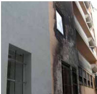
Wenige Millimeter entscheiden über Schäden
