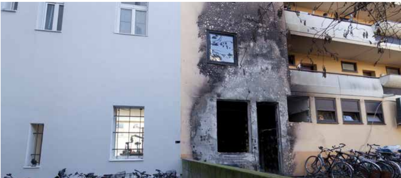
Zwei ungleiche Nachbarn: Links: Völlig intakte maxit WDVS-Fassade mit mineralischem Putz Rechts: Durch Sprengwirkung zerstörtes, dünn-schichtig und pastös verputztes Fassadensystem
