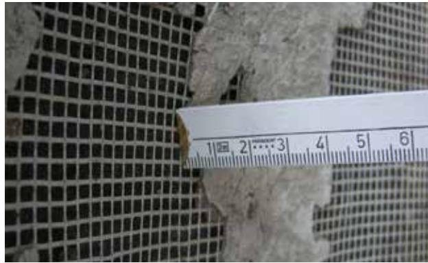
Die wenig Millimeter starke Putzschiicht hatte der massiven Gewaltwirkung nichts entgegenzusetzen
