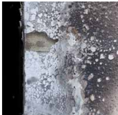
Pastöse, dünnschichtige Putze auf Kunstharzbasis wurden stark beschädigt, platzten ab und gaben die darunter liegende Polystyrol-dämmschicht frei
